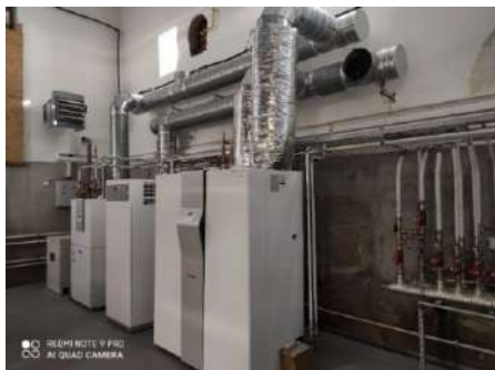
Vykurovací a chladiaci systém s obnoviteľným zdrojom energie v podobe tepelných čerpadiel
