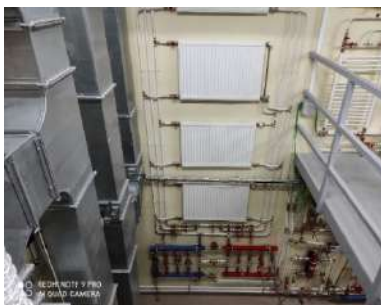
Hydraulická stena určená na simuláciu rôznych stavov vykurovacieho systému
